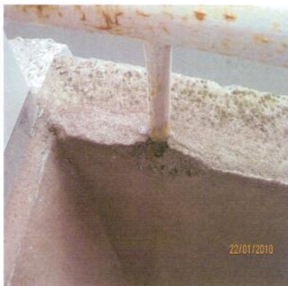
Afsprængt beton grundet rusten håndliste
