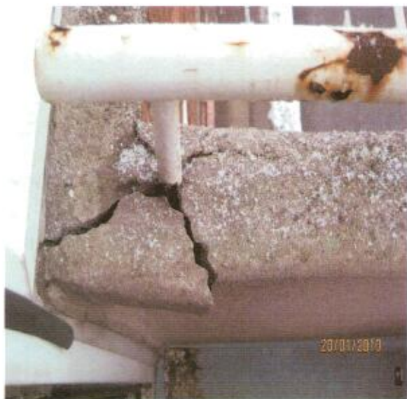
Flækket betonværn grundet rusten håndliste
