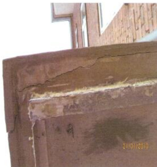
Revnet beton grundet rustent udliggerjern
