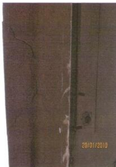
Revnet beton grundet rustent udliggerjern
