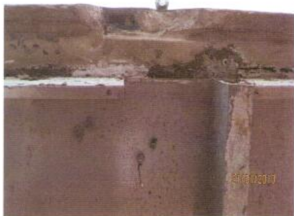
Afsprængt betondæklag ved udliggerjern
