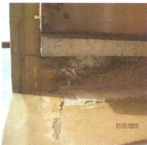
Revnet beton grundet rustent udliggerjern
