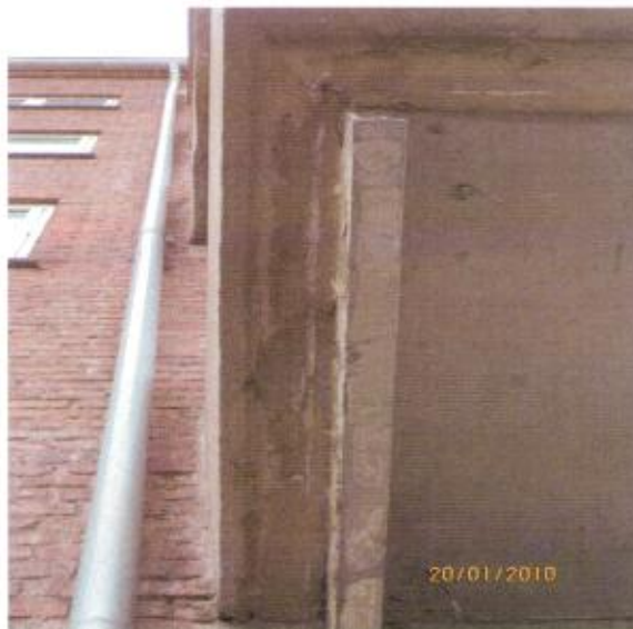
Revnet beton grundet rustent udliggerjern
