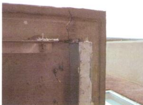
Revnet beton grundet rustent udliggerjern
