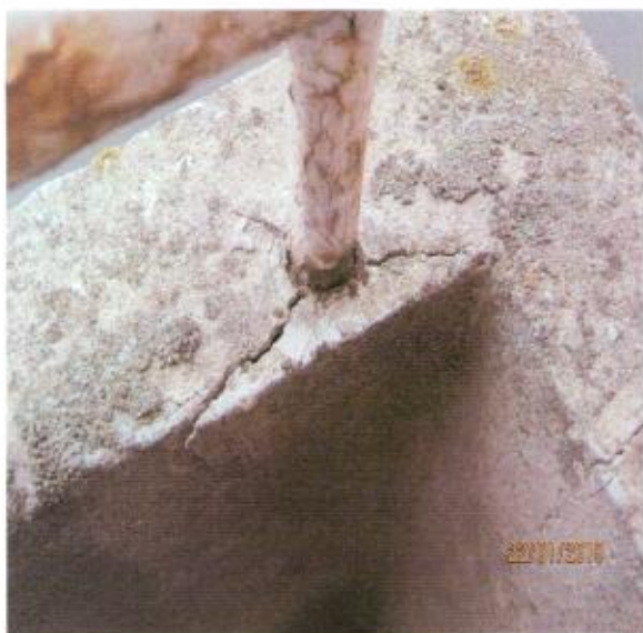
Afsprængt beton grundet rusten håndliste
