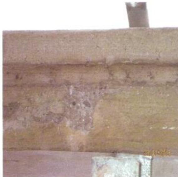
Revnet beton grundet rustent udliggerjern
